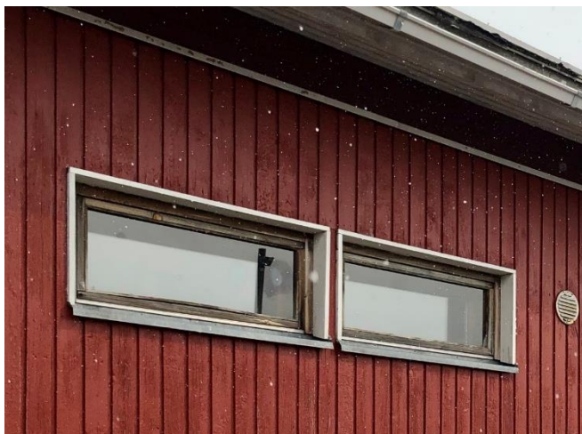
Kuvat 5 ja 6. Kalankäsittelyhallin ikkunat ja vesikalusteet ovat uusimisen tarpeessa.
